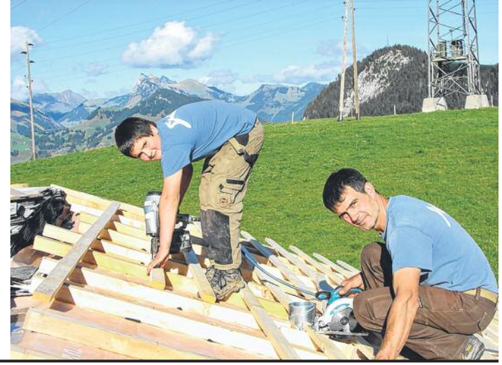
Joël Mottier et son fils Isaac sur un nouveau rural en construction à 1400 mètres d'altitude, près de La Lécherette.
